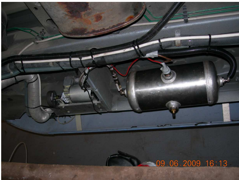
Conjunto compresor-calderín montado
