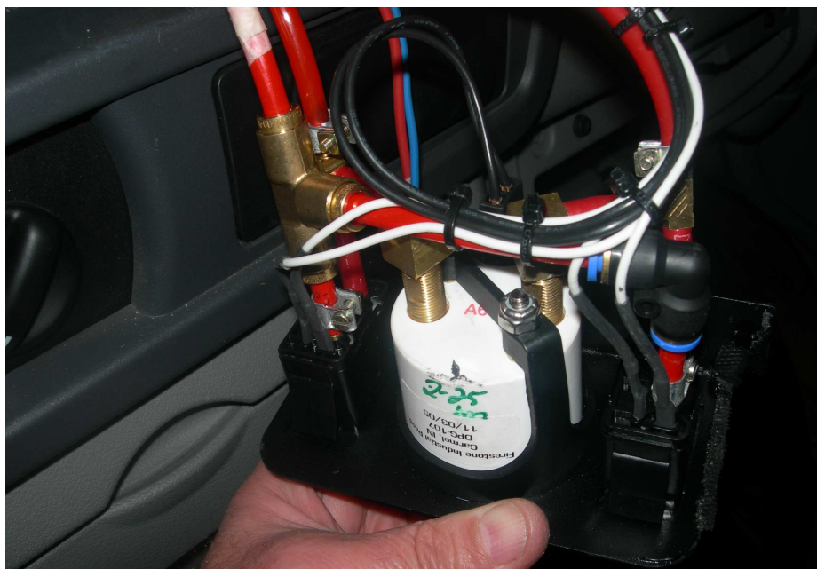
Vista conexiones eléctricas y neumáticas en las válvulas de inflado
