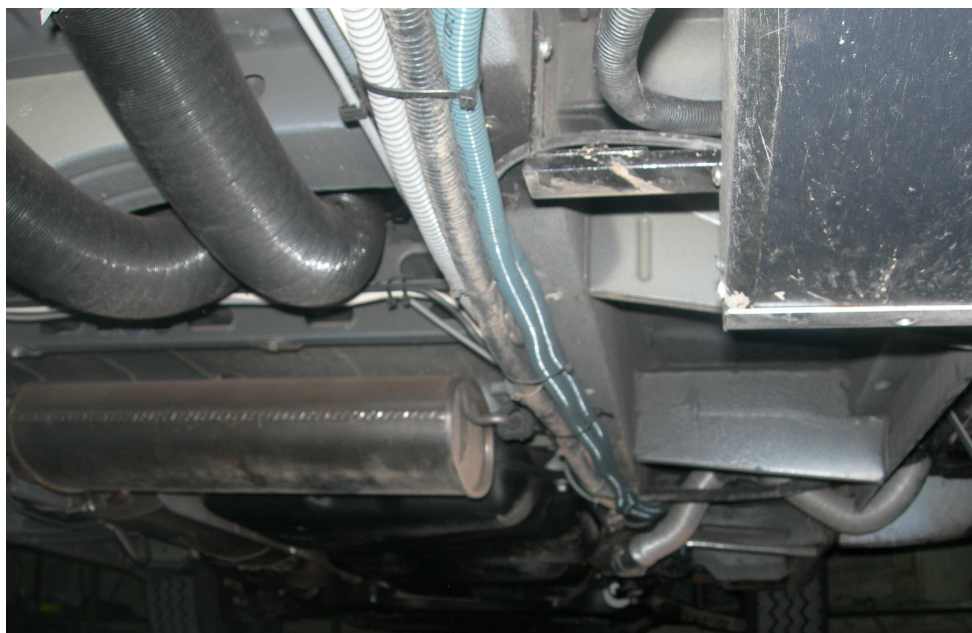
Vista de la sujeción de los tubos neumáticos protegidos por un tubo eléctrico y sujetos por medio de bridas
