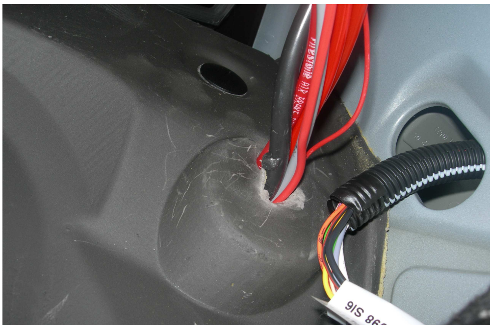
Paso de los tubos neumáticos y los cables eléctricos de marcha del compresor desde la cabina al compartimento motor
